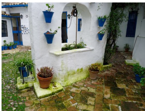
Casa-patio de Trueque 4, estado actual, edificio desocupado
